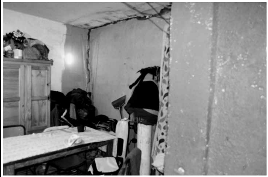
Fotografía 13. Dormitorio-comedor de la casa de “Carmen”. Resulta visible la grieta en la pared que la separa de las restantes y del techo producto de haber cedido el suelo.
